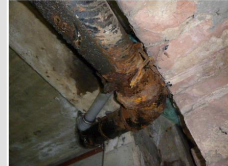
2020_H AUSSTATTUNG ROHRVERBINDUNG UNDICHT
