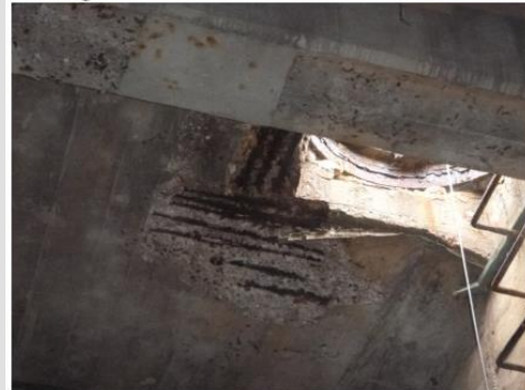
2020_H_PFEILER ABPLATZUNG DECKENUNTERSEITE
