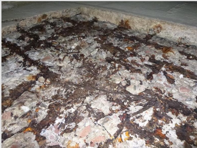
[511] S=1, V=0, D=3 BSP-ID 021-10 Decke Pfeilerinnenraum, Beton, Mehrfach, Abplatzung mit freiliegender Bewehrung, Unterseite, im Bereich der Einstiegschächte
