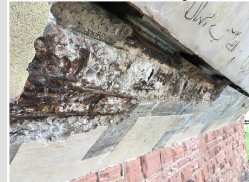
2020_H_PFEILER ABPLATZUNG AUFLAGERBANK
